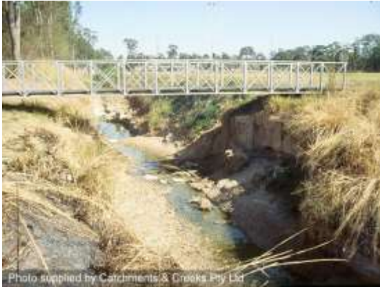
Bed scour (Qld)
