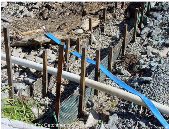
Sediment weir (Qld)
