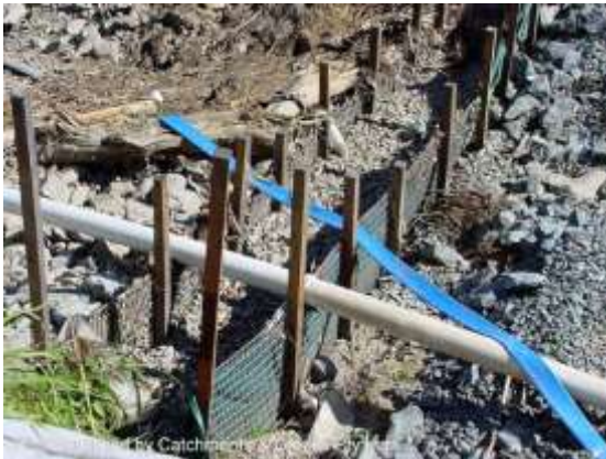
Sediment weir (Qld)
