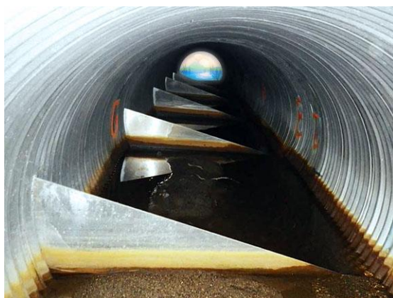
Corner baffles (USA)
