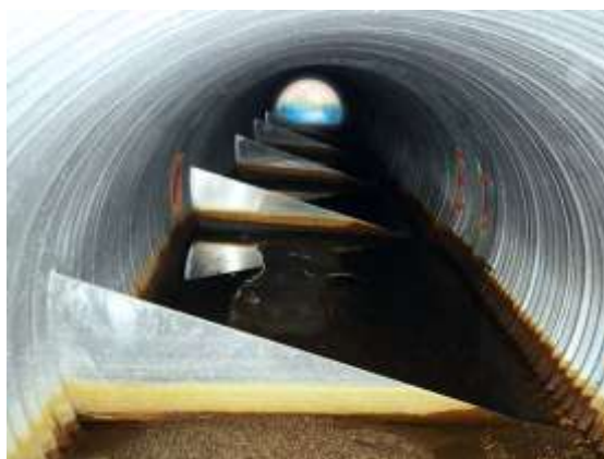
Corner baffles (USA)
