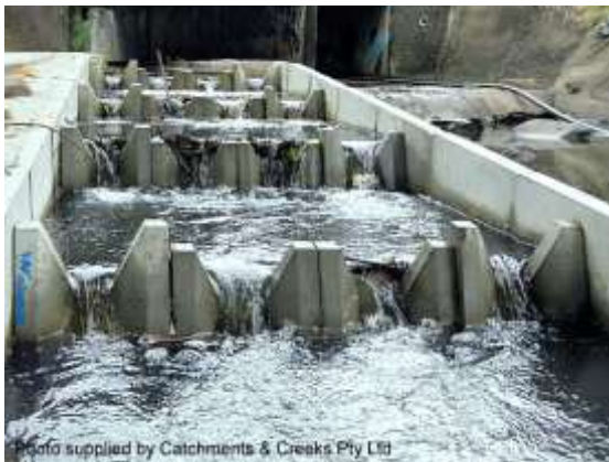
Fishway ramp (Qld)
