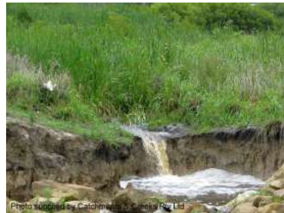
Erosion on the edge of a lake (NSW)
