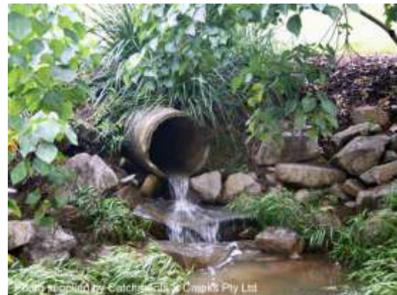
No headwall (Qld)
