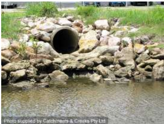
No headwall (Qld)
