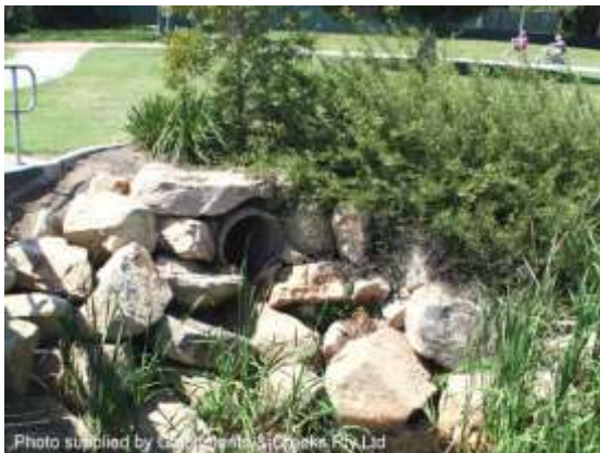
No headwall (Qld)
