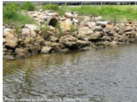
No headwall (Qld)
