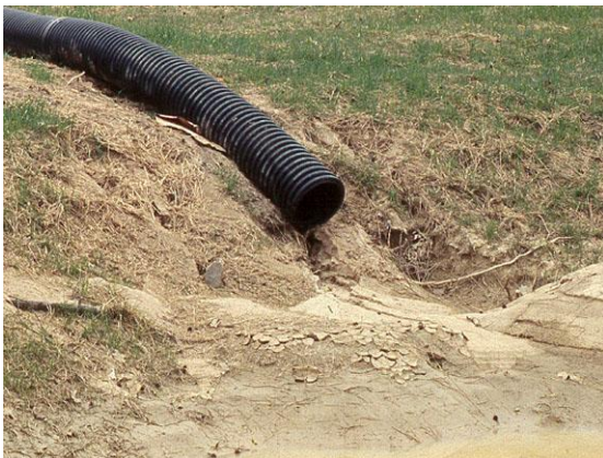
Sediment trap outlet (1995)
