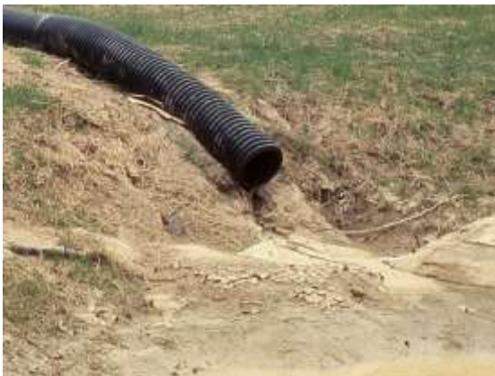
Sediment trap outlet (1995)
